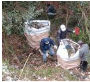
3班 大型クレーンを設置 路肩の谷からモッコをトラックに積み込む
